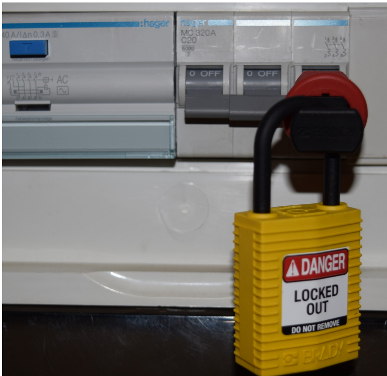
Wyłącznik izolacyjny zablokowany kłódką
